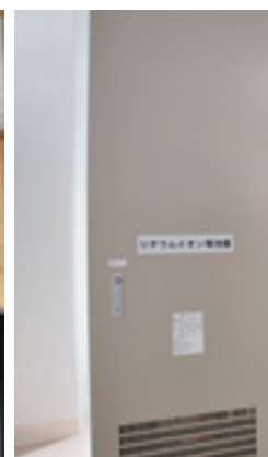
蓄電池システム
