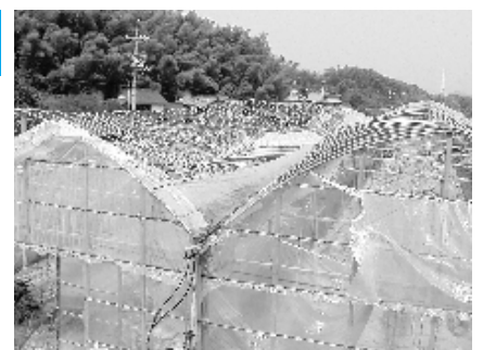
施設ハウスの被害の状況
