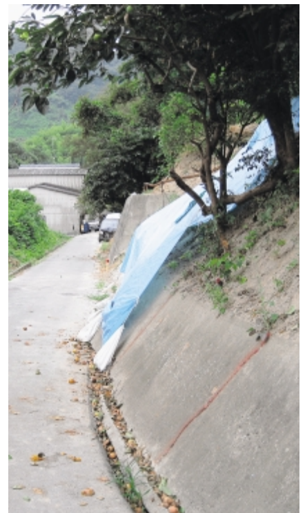
大雨による土砂崩れ現場
