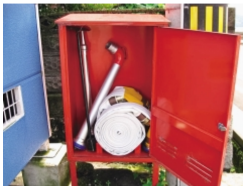
消火栓ボックス
